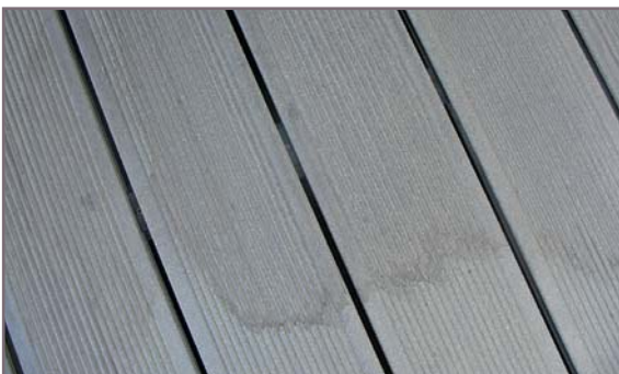
Wasserflecken bei teilweise überdachten Terrassen
